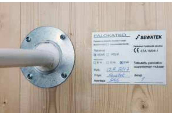
Palokatkon merkintä rakenteeseen | Fire stop sticker on a structure
