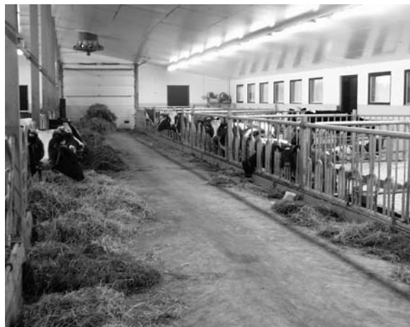
Kuva 23. Tuotantorakennuksessa koneellinen ilmanvaihto (Kuva EK-Maaseutukeskus)
