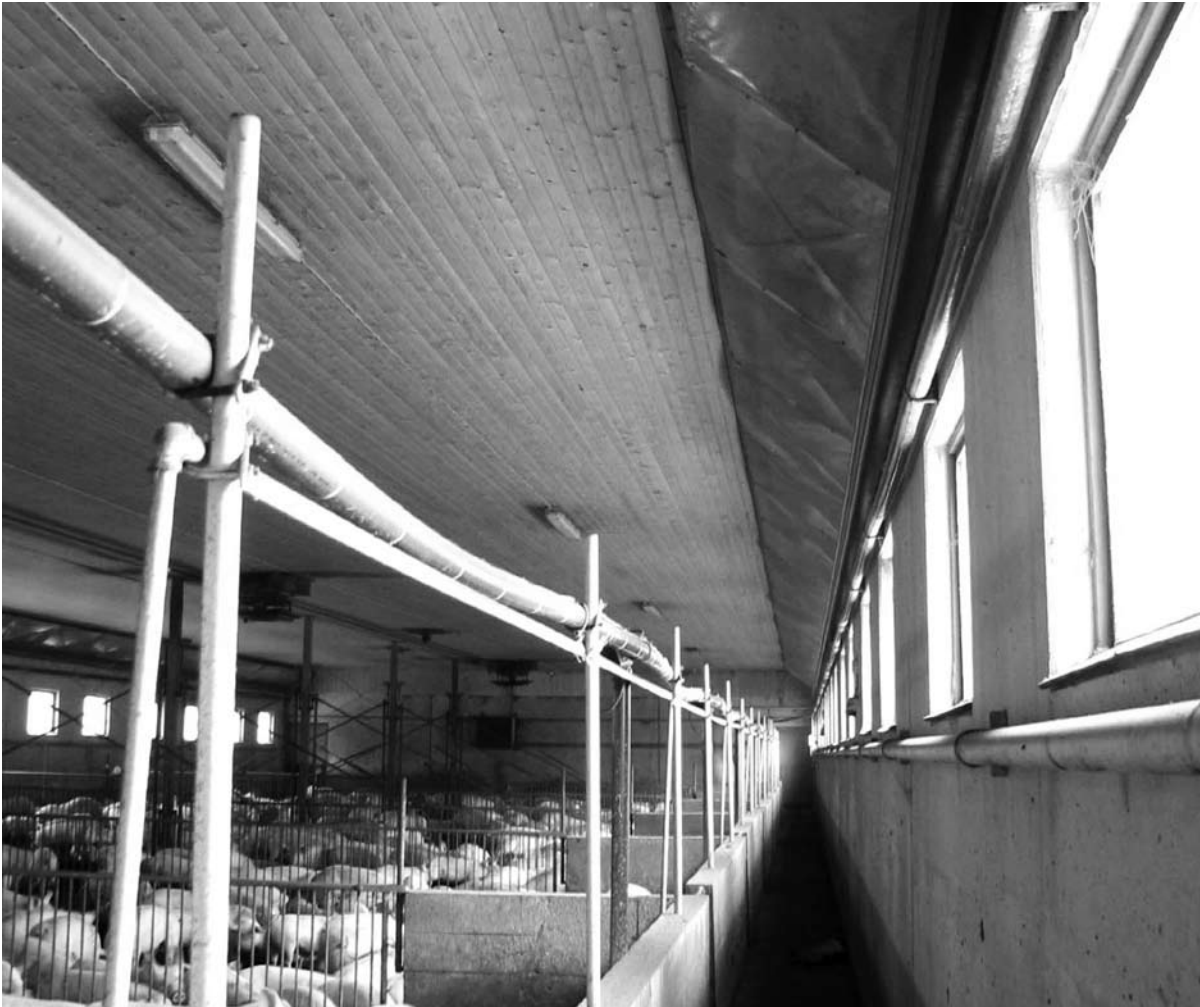
Kuva 18. Itkupintatuloilmalaite ulkoseinän ja alakaton rajakohdassa (Kuva Tapani Kivinen)
