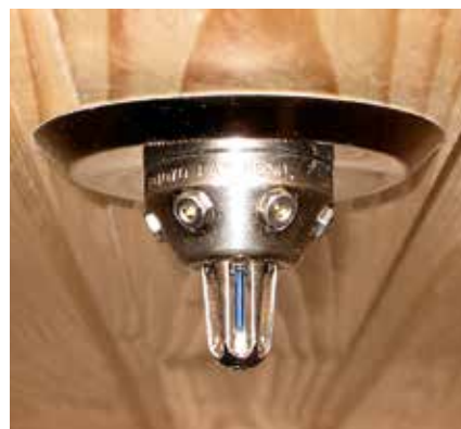
Kuva 66. Korkeapainevesisumujärjestelmän suutin oppoasennettuna asuinkerrostalon kattoon. Kuva: Versowood
