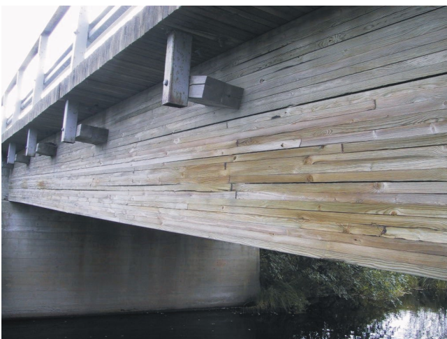
Kuva 2. Korjausta vaativia halkeamia ja liimasaumojia.
