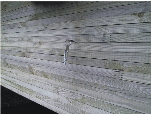
Kuva 1. Liimapuupalkin normaalia halkeilua, joka ei vaadi korjausta.
