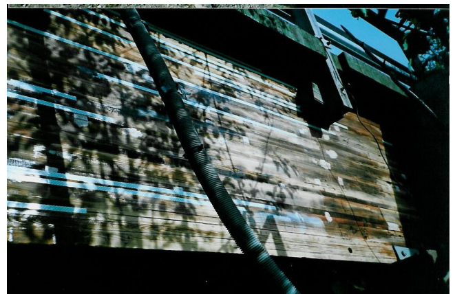
Kuva 3. Halkeamat on suljettu teipillä.
