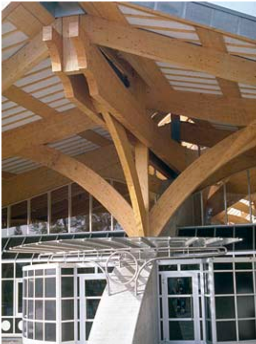
Kuva 10.10 Jäähallin päädyn ulkopuolisia liimapuurakenteita.
