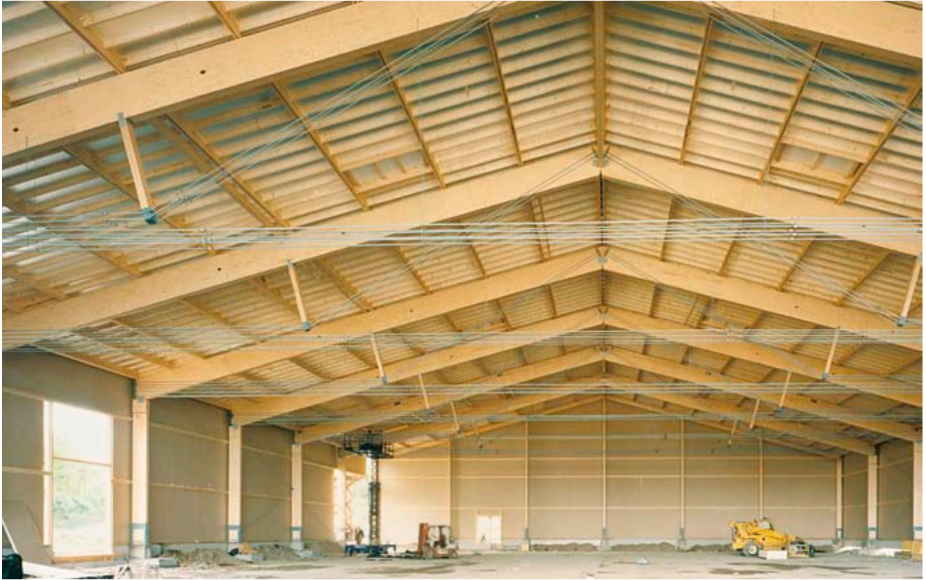
Kuva 5.1 Vetotangoilla toteutettu halli muodostuu sisältä ilmavaksi. Nokian jäähalli.
