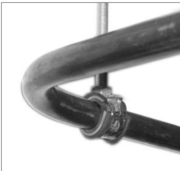
Kuva 42. Ääniteknisesti hyvä putkikannatin.
