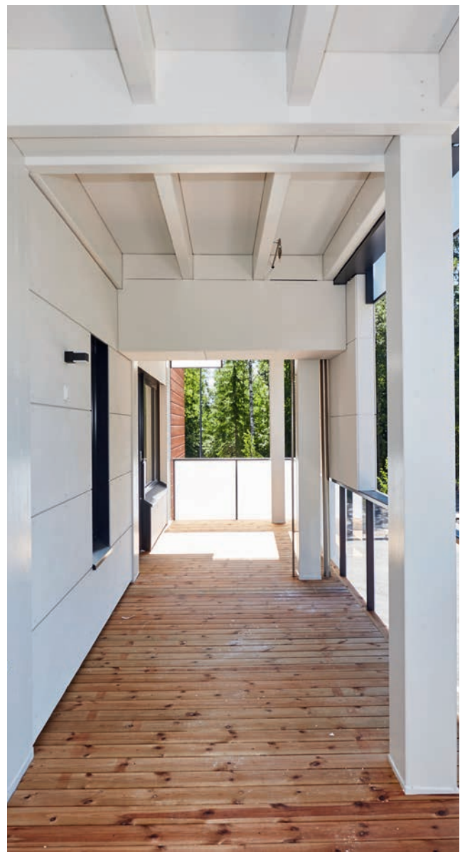
Kuva 70. Korkeapainevesisumujärjestelmän suutin varatieparvekkeen lattiapalkin viereen asennettuna. Kuva: Puiifo.
