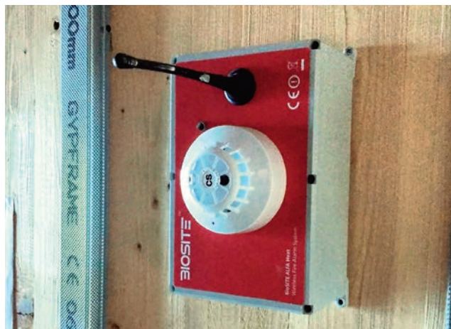
Kuva 65. Rakennustyömaalla käytössä oleva langaton palovaroitinjärjestelmä.
