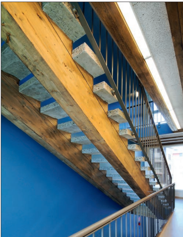
Kuva 60. Portaan B-s1, d0-luokan puurakenteiset kannatinpalkit eivät tarvitse suojaverhusta P2-paloluokan puukerrostalossa (vähäinen rakennusosa). Kuva: Metsä Wood
