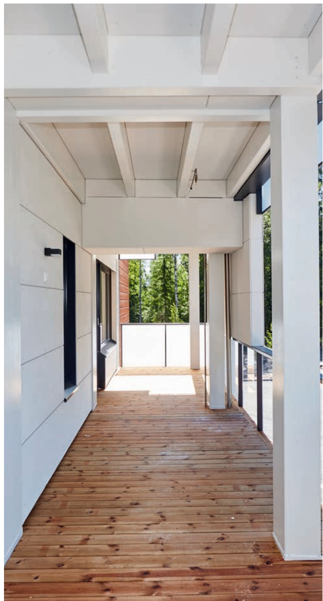
Kuva 70. Korkeapainevesisumujärjestelmän suutin varatieparvekkeen lattiapalkin viereen asennettuna. Kuva: Puiinfo.
