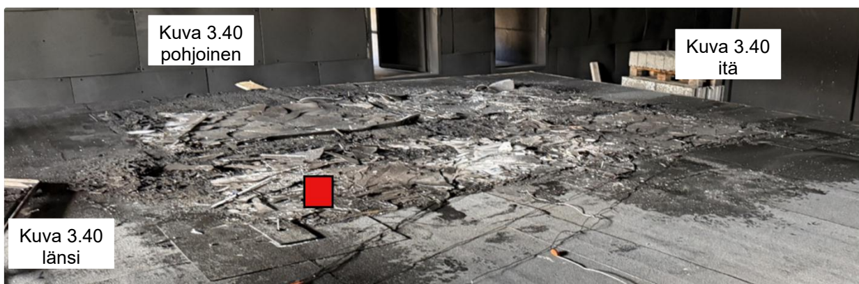
Kuva 3.39 – Koe 3 vaurioitunut alue
