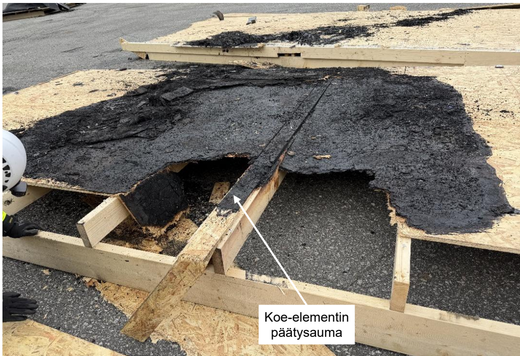
Kuva 3.55 – Koe 4 vaurioitunut OSB-levy
