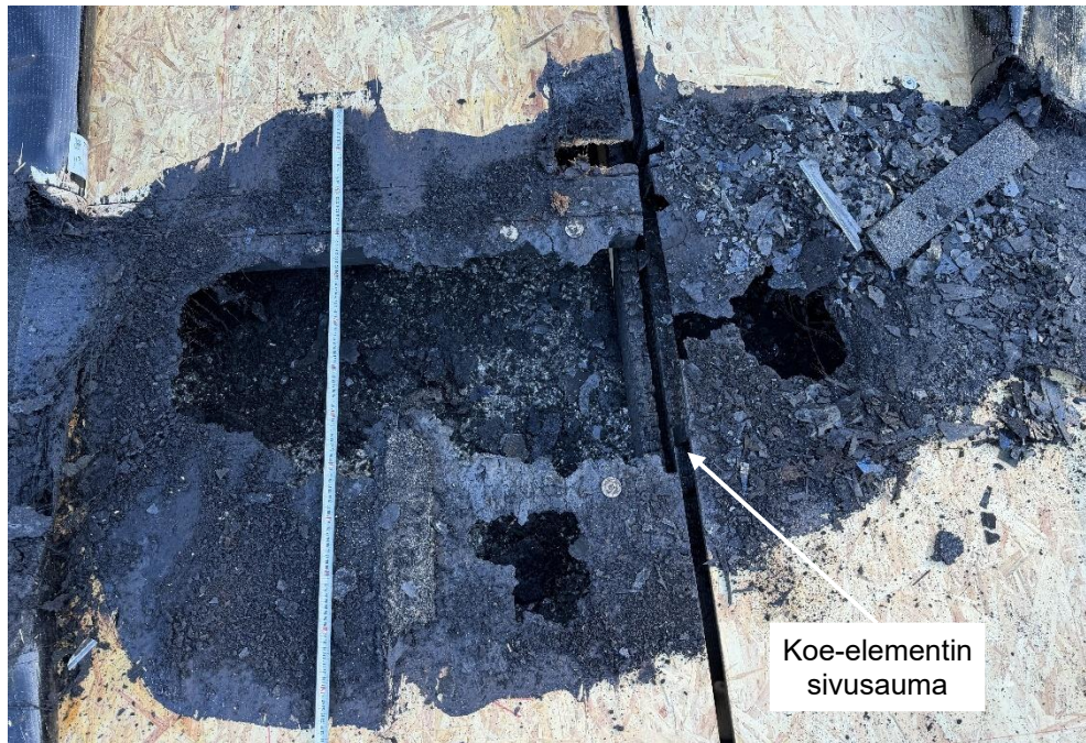
Kuva 3.15 – Koe 1 vaurioitunut OSB-levy
