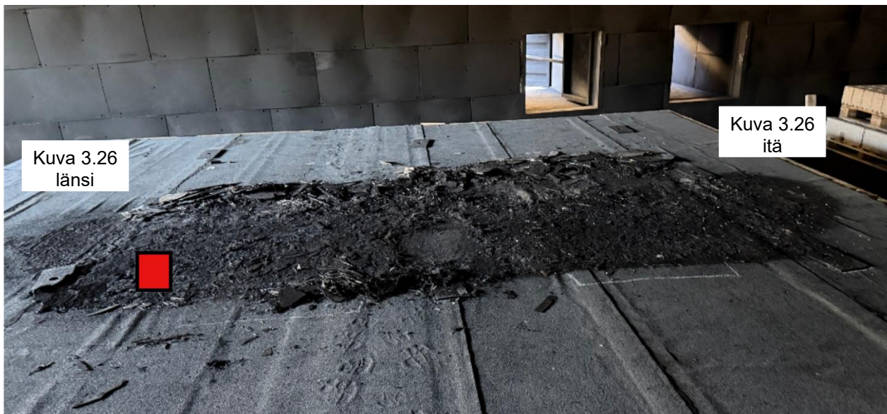
Kuva 3.25 – Koe 2 vaurioitunut alue
