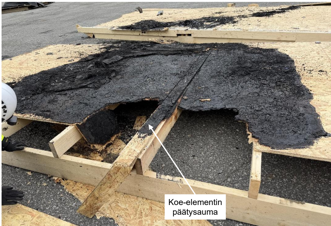
Kuva 3.55 – Koe 4 vaurioitunut OSB-levy
