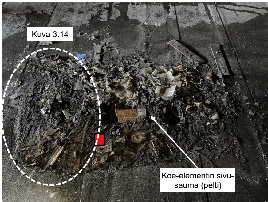
Kuva 3.13 – Koe 1 vaurioitunut alue
