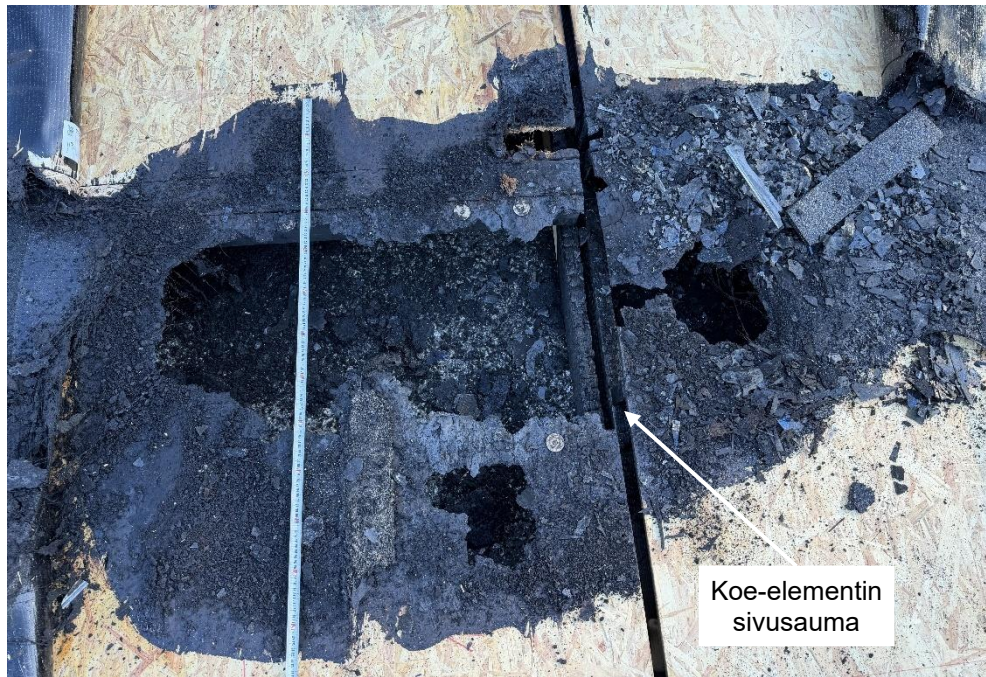
Kuva 3.15 – Koe 1 vaurioitunut OSB-levy
