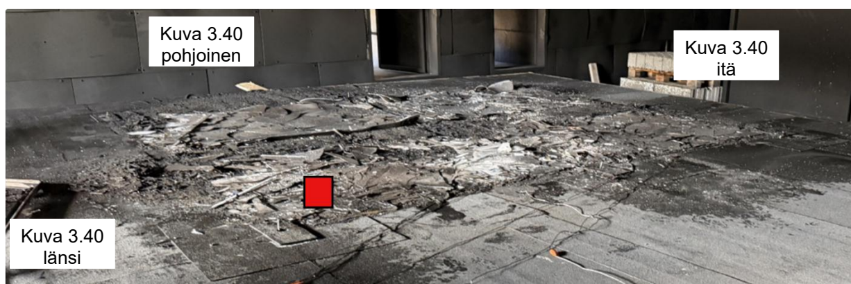
Kuva 3.39 – Koe 3 vaurioitunut alue
